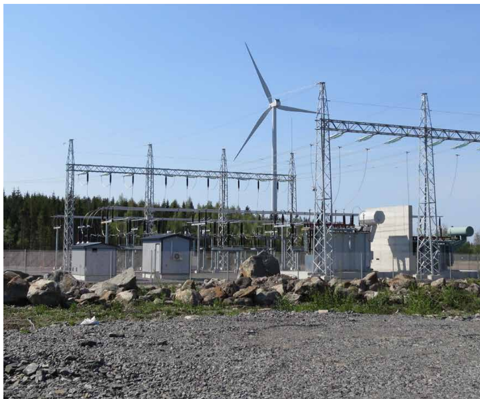
Kuva 2. Sähköasema Porin Peittoossa (Mariikka Manninen).
